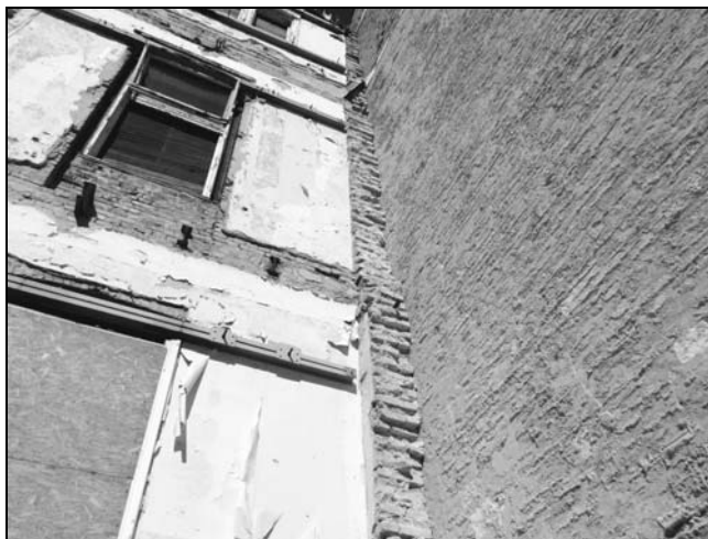
5. ábra. A vasbetonkoszorúk hiányát igazolja az Eötvös utcai bontott épület falmaradványa
