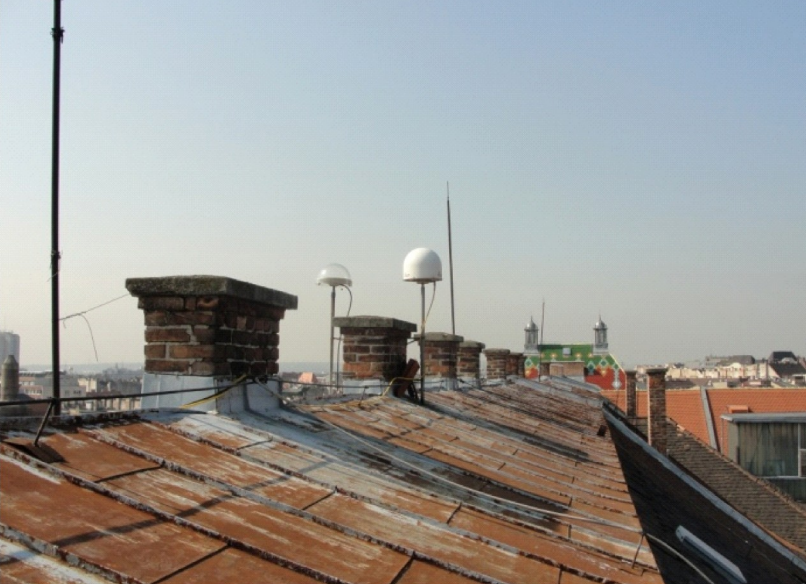
EGNOS monitor állomás antennája a BME Központi épületének tetőjén
